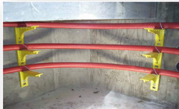
Figura 3.20 Ménsulas para el soporte de los cables.
