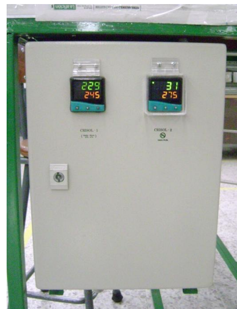
Fig. 29b.- Centro de control.
