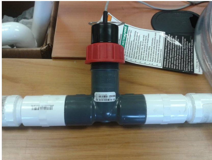
Figura 3.45: Sensor de flujo instalado en circuito de prueba.
