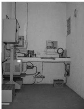
Fig. 1.3. Interior Cuarto de Instrumentos.
