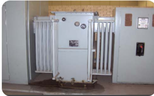
Transformador tipo subestación.
