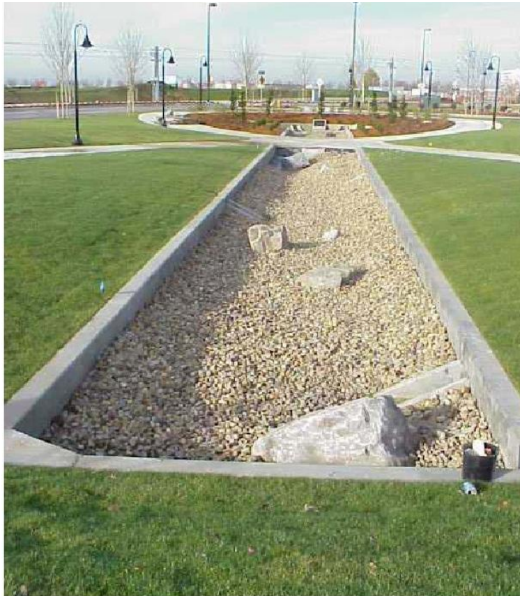
Figura 4.10 Filtro de arena como lecho de infiltración (1).
