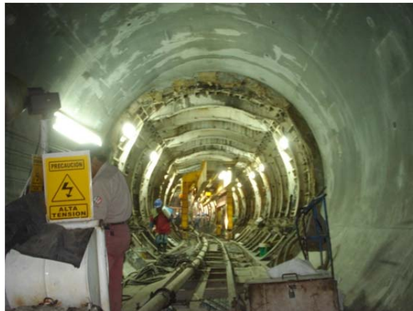
FIG. 2.5.5 A Alimentación eléctrica e iluminación
