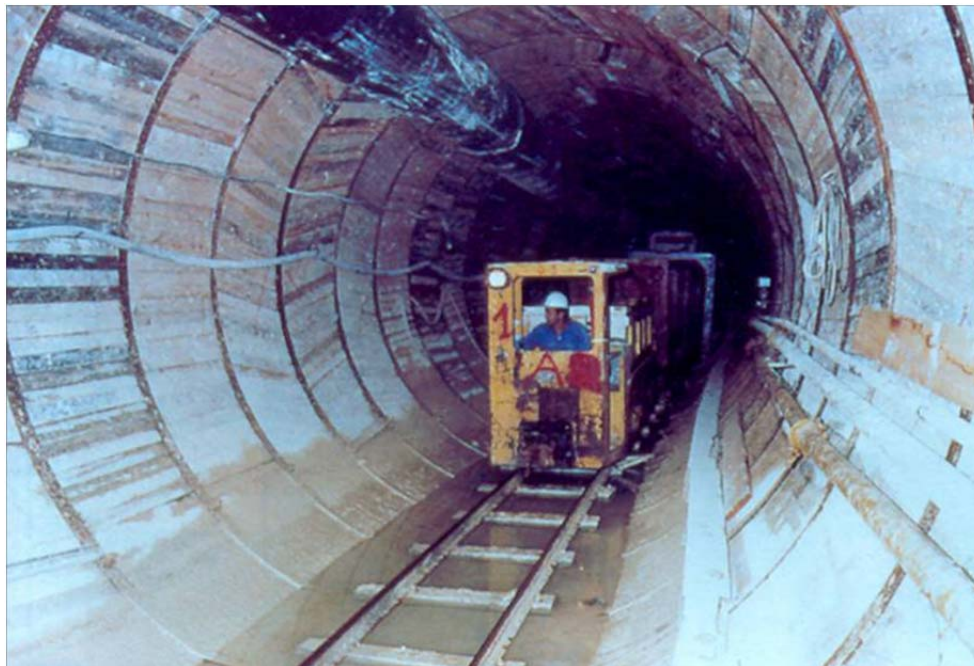
Fig. 2.3.5 Estabilizado de paredes del túnel por medio de anillo metálico y polines.
