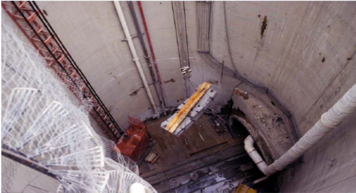
Fig. 2.1.1 Lumbra de operación y mantenimiento.
