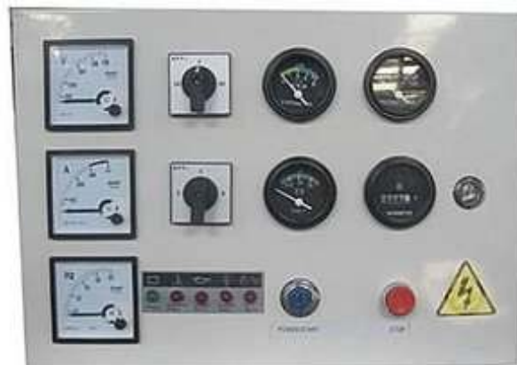
Figura 4.7 Panel Indicador de parámetros eléctricos
