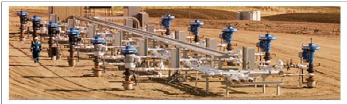
Figura 1.8 Sistemas BCP instalados en un campo de aceite 4
