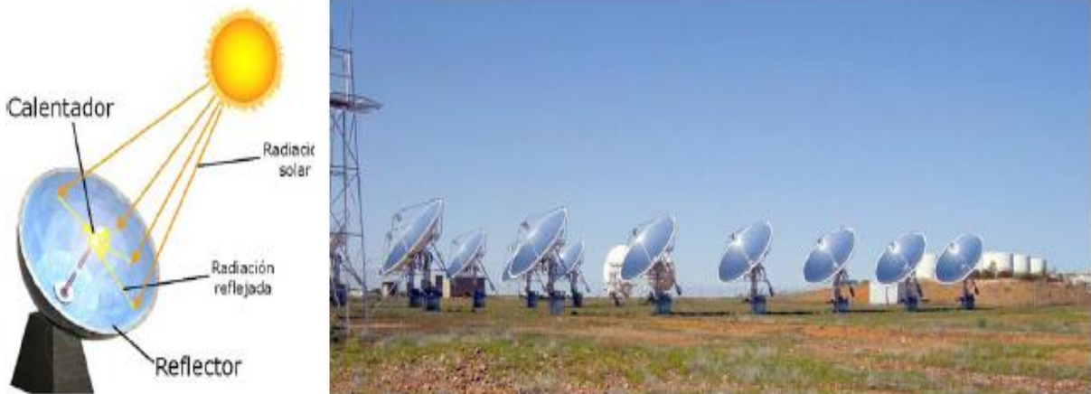
Figura 1.41.- Captadores de discos parabólicos 38
