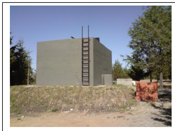
Figura No. 8. Tanque de almacenamiento de agua tratada
