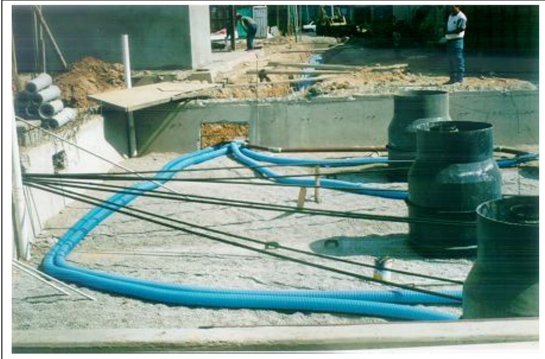
Foto 19 Conexión de las tuberías de producto a las motobombas de los tanques
