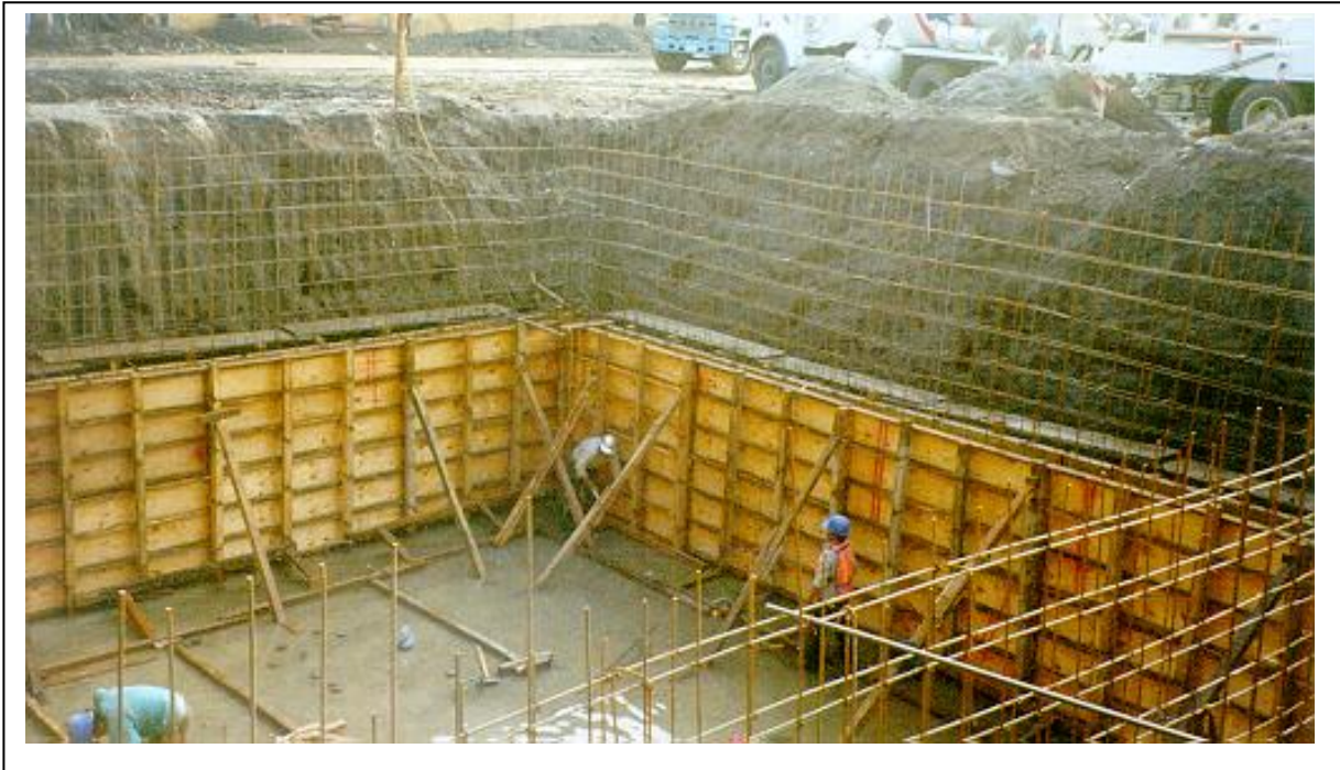
Foto 5 Preparación de cama y trazo para la colocación de los tanques de almacenamiento
