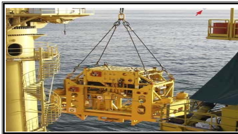
Fig. 4.4 Dos bombas multibooster fueron instaladas en el Campo King
