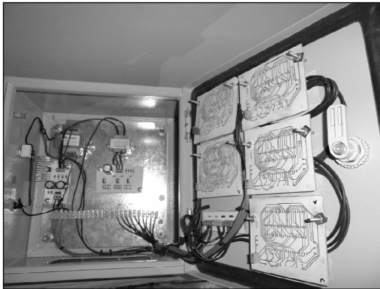
Figura 4.17 Interior del gabinete de control
