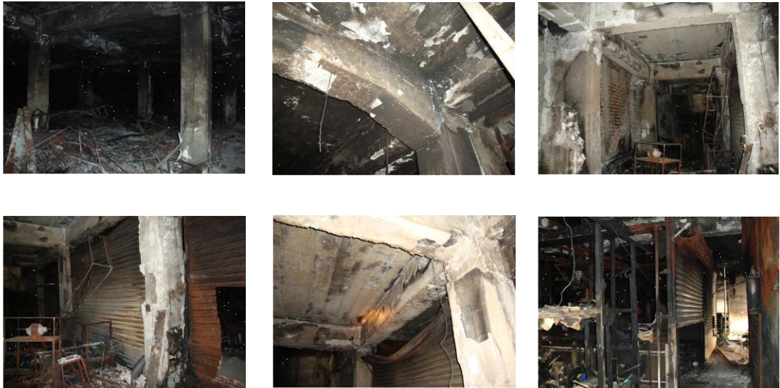
VISTA DEL INTERIOR DEL INMUEBLE, EN DONDE SE PUEDE OBSERVAR LAS CORTINAS METÁLICAS AFECTADAS POR EL INCENDIO, ASÍ COMO DAÑOS EN EL APLANADO DE TRABES, COLUMNAS Y PLAFÓN.
