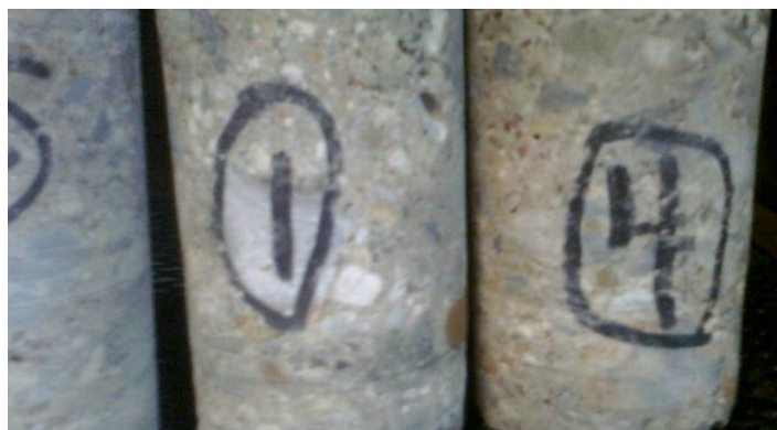
Figura 2. Se muestran los núcleos de concreto obtenidos de la estructura del Mercado León.
