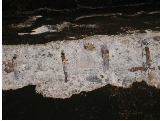
Figura e. Ponga atención en el contorno de la cala, y percátase de la coloración “rosa pálido” misma que nos indica la penetración de calor dañino al elemento estructural de concreto reforzado, la pigmentación del concreto indica la penetración de la temperatura dañina, que a simple vista es de 3 a 5 mm, por lo que es posible establecer que ni concreto ni refuerzo de la estructura se vieron afectados por la intensidad de fuego.
