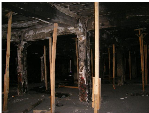
Figura d. Se observa una vista de la estructura siniestrada por fuego en tonalidades oscuras las más y claras las menos, lo que nos muestra evidencia de diferentes temperaturas en la zona.
