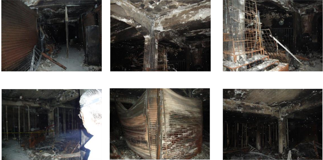
VISTA DEL INTERIOR DEL INMUEBLE, EN DONDE SE PUEDE OBSERVAR LAS CORTINAS METÁLICAS AFECTADAS POR EL INCENDIO, ASÍ COMO DAÑOS EN EL APLANADO DE TRABES, COLUMNAS Y PLAFÓN.
