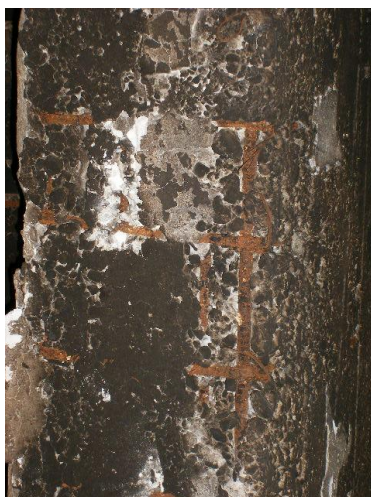
Figura c. La figura nos muestra que el recubrimiento se fue perdiendo respecto del tiempo dejando al descubierto al acero de refuerzo, la pérdida del recubrimiento obedece al diagnóstico planteado párrafos atrás, donde se plantea que la adherencia entre las partículas es deficiente, lo que ocasiona que paulatinamente esto ocurra en los elementos. En estas condiciones es muy probable que el acero sufra un proceso de corrosión que afecte al final a la resistencia del elemento.
