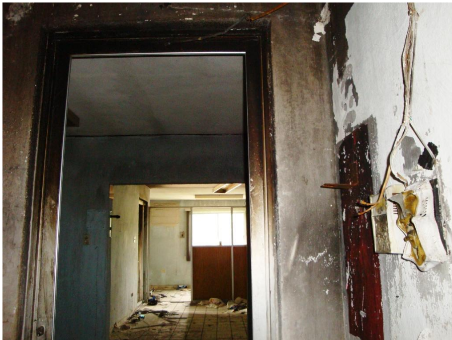
Figura C.- obsérvese los controles de temperatura, los cuales solamente sufrieron deformaciones, a consecuencia del calor provocado por el incendio, estos controles se encuentran aproximadamente a 2.5 mts de la columna de concreto armado No. 7 (ver croquis anexo) que de acuerdo a lo comentado por los asesores del asegurado, dicha columna también sufrió daños por el incendio
