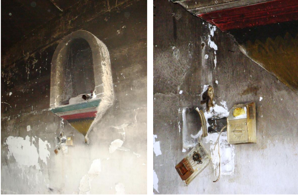
Figura D.- obsérvese los controles de temperatura, los cuales solamente sufrieron deformaciones, a consecuencia del calor provocado por el incendio, estos controles se encuentran a la altura de la columna de concreto armado No. 6 (ver croquis anexo) que de acuerdo a lo comentado por los asesores del asegurado, dicha columna también sufrió daños por el incendio
