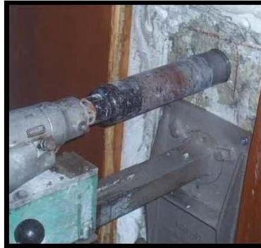
Figura 1. Se presenta la forma en la que fue colocado el equipo de extracción para la obtención de muestras de concreto.
