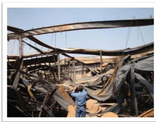
Figura II.I Revisión de los elementos estructurales Afectados por el incendio.
