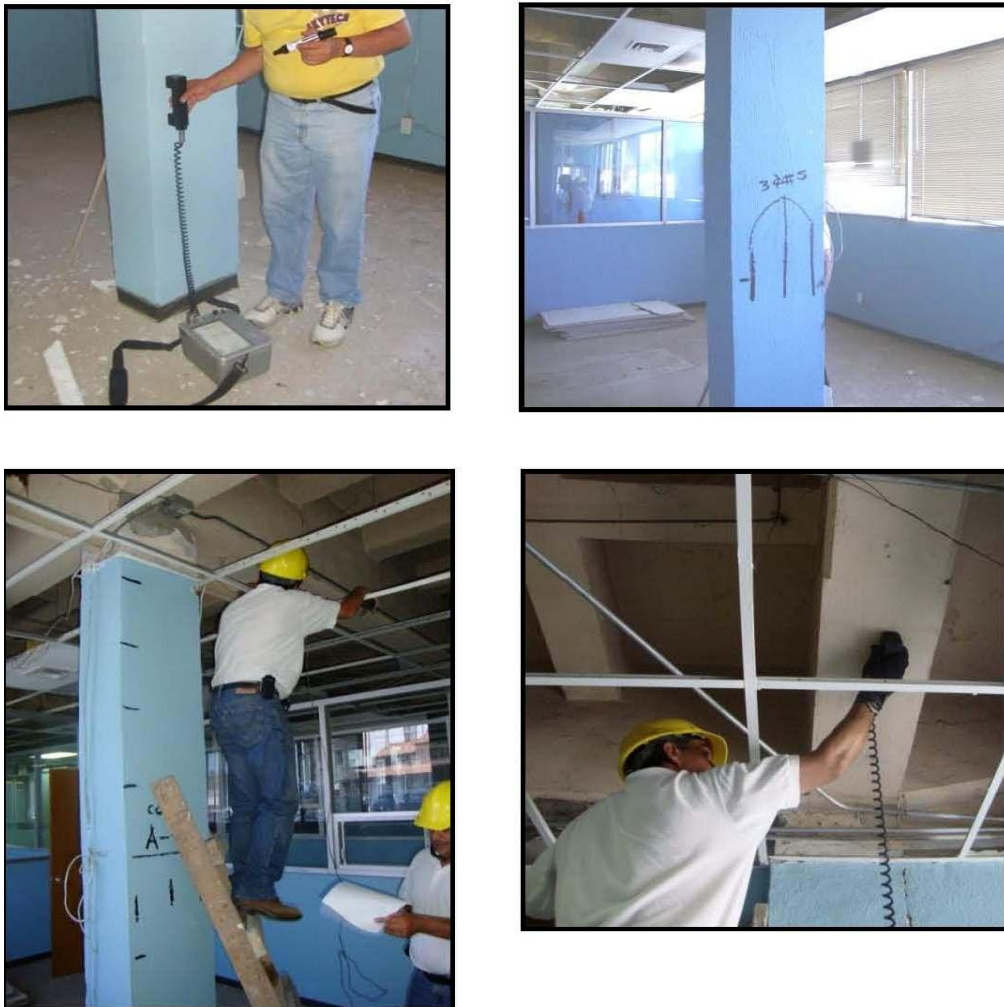
Figura 8. Detección de acero de refuerzo en una columna, en la que se obtuvo el armado que poseen las columnas del inmueble inspeccionado
