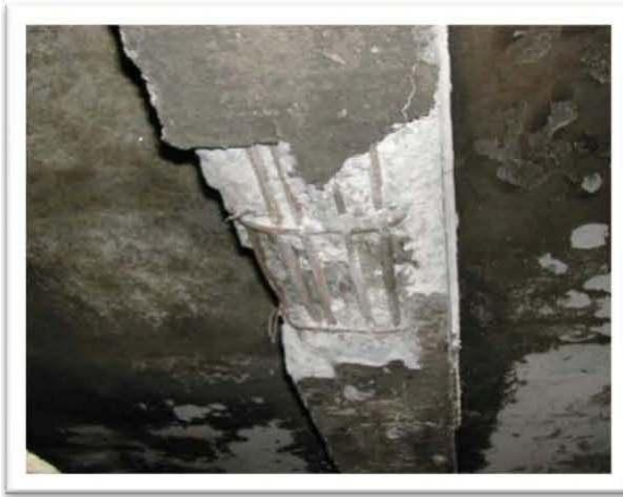
Figura II.VI Vista del desconchamiento en una trabe
