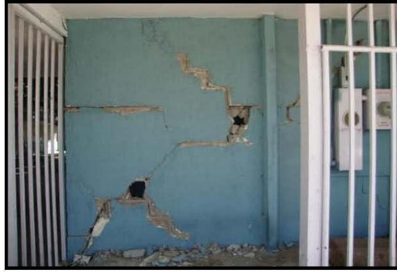
Figura a. Fallas de tensión diagonal en mamposterías ocasionadas por fuerzas sísmicas
