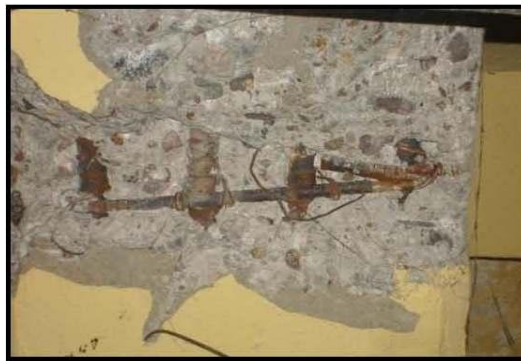
Figura 6. La cala que se presenta en una de las vigas principales que nos permitió observar barras del #5 en el lecho bajo y estribos del #3.
