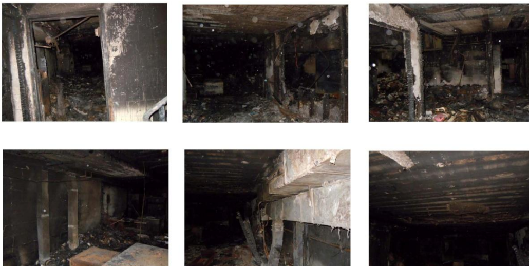
VISTA DE LOS DAÑOS OBSERVADOS EN EL PRIMER NIVEL, LUGAR EN DONDE SE ORIGINO EL INCENDIO RESULTANDO AFECTADOS: MUROS DE TABLARDOCA, FALSO PLAFON, INSTALACION ELECTRICA, DUCTOS DE AIRE ACONDICIONADO, PUERTAS Y VENTANAS DE MADERA.
