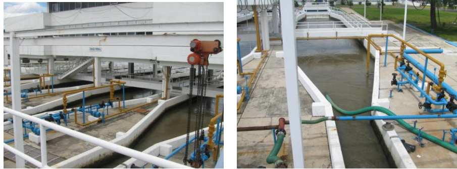
Figura 1.4 Medidores Parshall en la planta Los Berros
