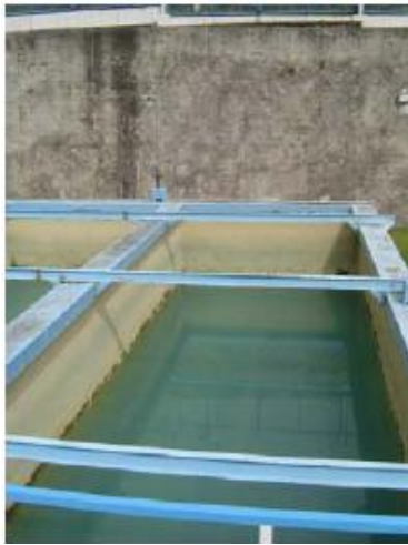
a) Tanque de filtración
