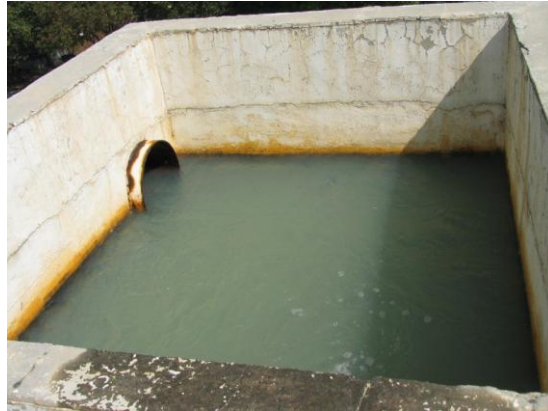
Figura 1.9 Caja amortiguadora en la planta Madín
