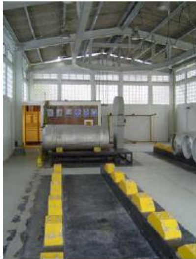
a) Sistema de cloración en gas
