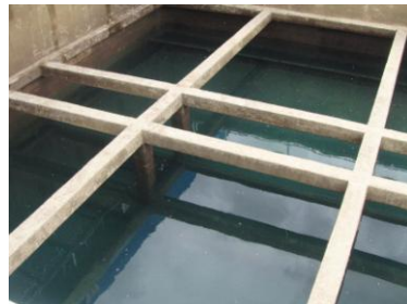
Figura 1.7 Filtración final en la planta Los Berros
