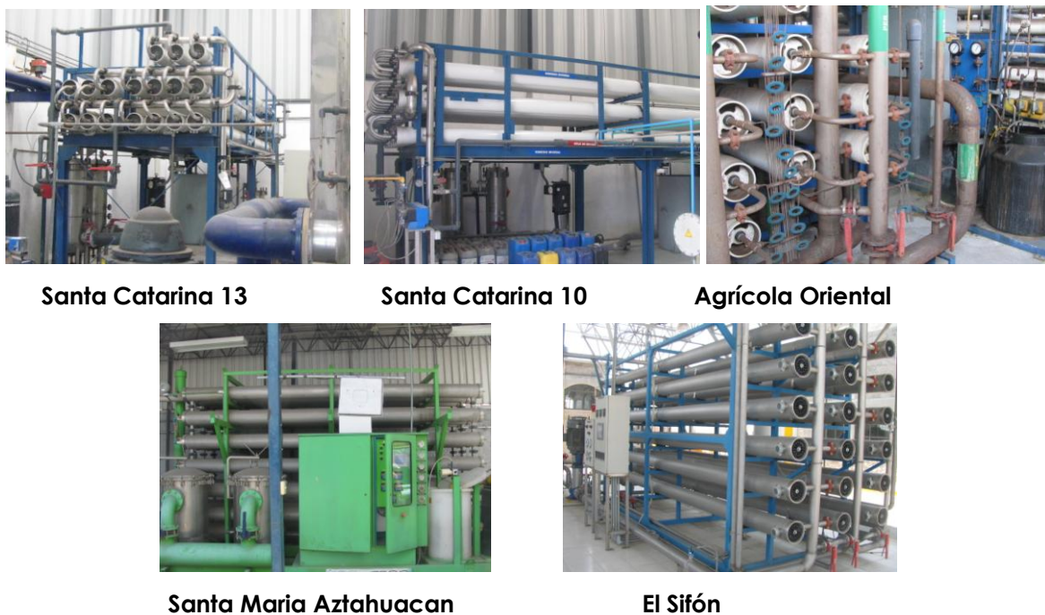
Figura 1.20 Equipos de ósmosis inversa en las plantas potabilizadoras avanzadas
