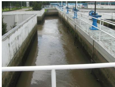
Figura 1.3 Tanque de recepción de aguas crudas en la planta Los Berros
