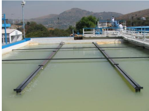
Figura 1.11 Tanque de floculación en la planta Madín
