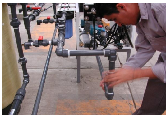
Foto 2. 5. Instalación hidráulica de filtros cartucho a bomba de alta presión.
