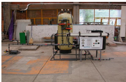
Foto 2. 8. Instalación hidráulica de la planta piloto de OI.
