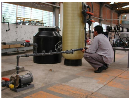
Foto 2. 3. Instalación hidráulica de bomba de alimentación a filtro a presión.
