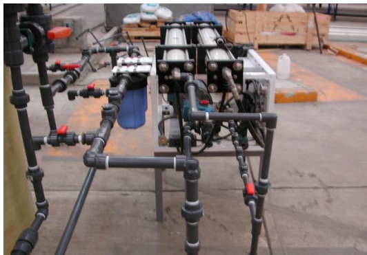
Foto 2. 6. Instalación hidráulica de bomba de alta presión a membranas de OI.
