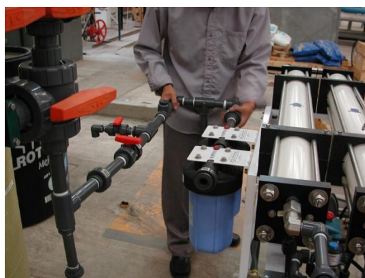
Foto 2. 4. Instalación hidráulica del filtro a presión a filtros cartucho.
