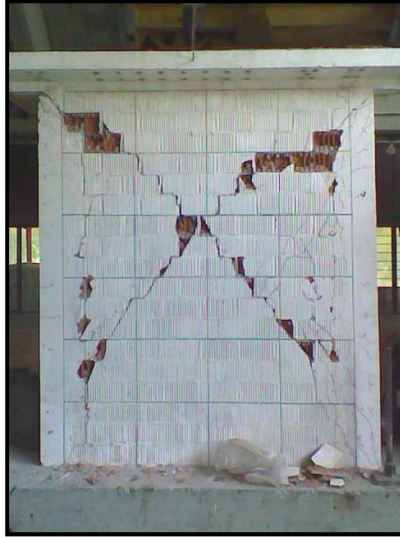
Figura 3.4. Estado final del muro ME3
