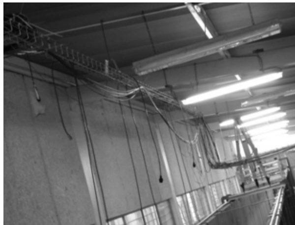
(b) Canaleta metálica
