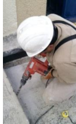
Imagen 17. El cable principal se encuentra bajo la superficie, se desea aterrizar una estructura en el exterior, por lo que se perfora para tener un atajo.
