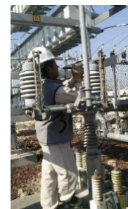
Imagen 42. Existen pequeñas barras de cobre que sólo pueden unirse por medio de zapatas, pues de otra manera el calor las derretiría.
