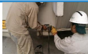
Imagen 43. El tanque de este transformador tiene un espacio exclusivo para colocar las zapatas que lo aterrizan.
