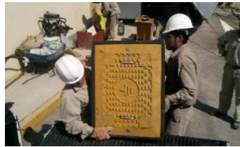
Imagen 23. Registro que sirve para ubicar y tener fácil acceso al electrodo de tierra para mantenimientos futuros.
