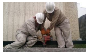
Imagen 20. Para aterrizar el ángulo metálico (de negro atrás de los trabajadores) se debe llegar a una trinchera que aloja el cable de tierra.
