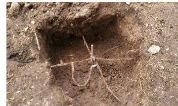
Imagen 16. Cruce de la malla y electrodo de tierra junto con su conexión, todas las uniones serán reemplazadas.
