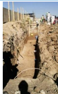
Imagen 73. Zanja para cimentación de una barda, en primer plano se aprecia el cable de tierra que fue arrancado.
