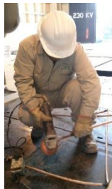
Imagen 51. Limando las rebabas que dejan los intersticios del molde al soldar una zapata al cable de cobre.
