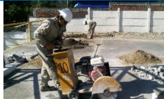
Imagen 7. Cortadora que ayuda a delinear en el concreto el área a excavar, de esta manera se tienen cortes limpios y con buena presentación.
