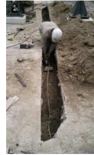
Imagen 14. Cable principal del cual surgen derivaciones y cruces, los cuales deben ser reemplazados.
