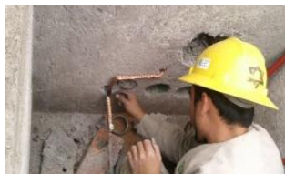
Imagen 35. Se aprecia claramente la unión del cable nuevo (más brillante), con cable antiguo.
