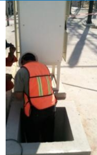
Imagen 74. Registro que obstruye el paso del cable de cobre de la malla de tierra.
