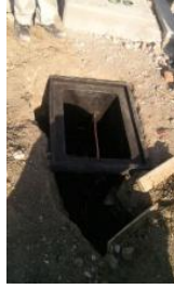
Imagen 29. Registro que resguarda el electrodo de tierra, se aprecia el cable que conecta y atraviesa hacia la malla de tierra.
