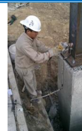
Imagen 52. Primeramente debe limarse la estructura a soldar y enseguida los remanentes de soldadura.
