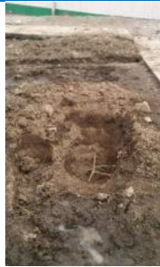
Imagen 15. Cruce de la malla de tierra dentro de una subestación eléctrica.
