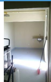
Imagen 66. Cuarto de baterías limpio, lugar donde permanecieron las herramientas de trabajo.
