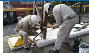
Imagen 40. Anteriormente, el cable de tierra estaba unido a las estructuras con zapatas y tornillos, estos fueron sustituidos con uniones sólidas de soldadura exotérmica.
