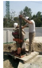
Imagen 32. Perforación que se realiza para facilitar la introducción del electrodo de tierra.
