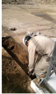
Imagen 13. Localización de la conexión del cable de una estructura con la malla de tierra.
