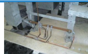
Imagen 44. Pueden verse varias zapatas unidas a una solera de cobre que funciona como un nodo de tierra para los interruptores.
