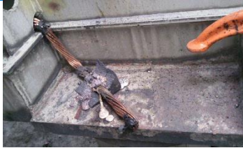
Imagen 71. Cable que debía unirse a la base metálica sobre la que está. El calor fundió el cable y no alcanzó a fundir la base, por lo que el cable se trozó.
