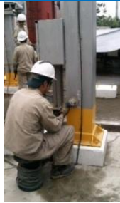
Imagen 49. Cabe destacar que para unir el cable a la estructura, primero debe limarse su superficie retirando pintura, óxido y dejando el metal al descubierto.
