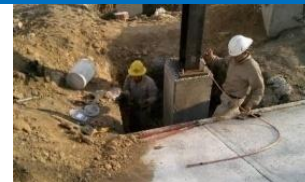
Imagen 36. Para aterrizar esta estructura se utiliza un tramo de cable que será unido a la malla de tierra que se encuentra enterrada.
