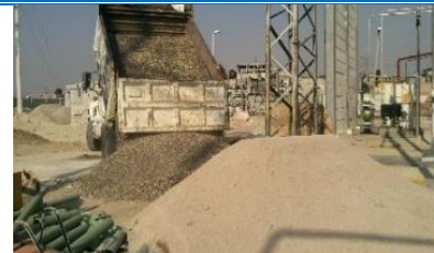
Imagen 24. Arena y grava que junto con el cemento formarán la mezcla que se usará para restablecer el piso.
