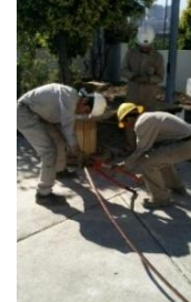
Imagen 34. El uso de arco y segueta es inadecuado para el corte del cable, lo que se usa son cizallas que son rápidas y eficientes para esta labor.
