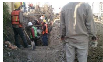
Imagen 76. Trabajadores realizando tareas ajenas en la zona donde corre el cable de la malla de tierra.
