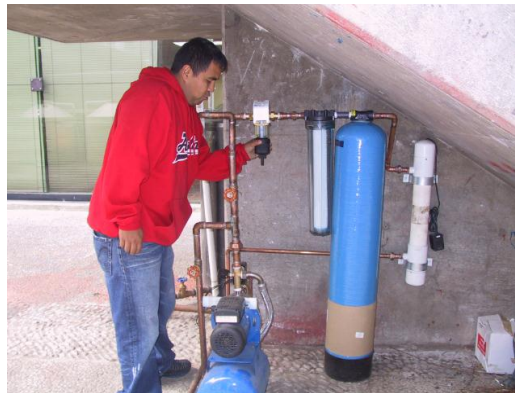
Figura 4.8 - Tren de Filtrado.
