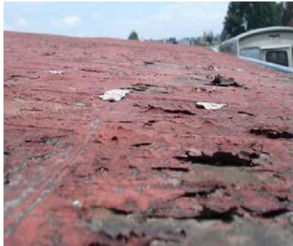
Figura 2.8 – Impermeabilización en mal estado.
