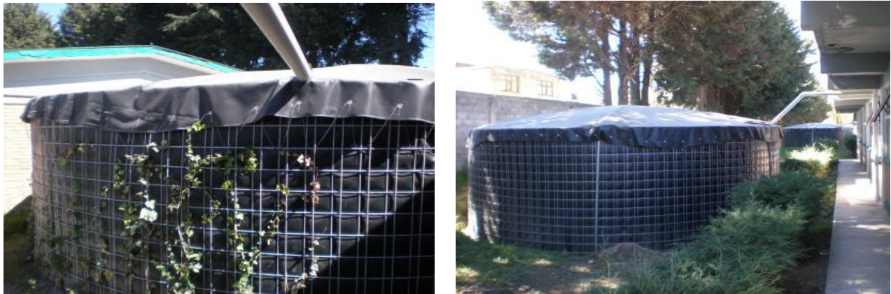
Figura 5.4 – Tanques de Geo-Membrana.
