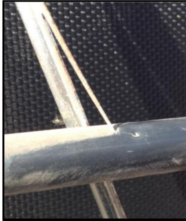
Ilustración 10. Foto de daño en cable
