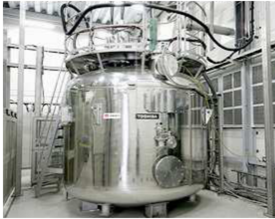
Figura 2.1.1.5.- Sistema súper conductor de energía magnética, suministra electricidad en caso de caídas de tensión por rayos y fenómenos naturales.
