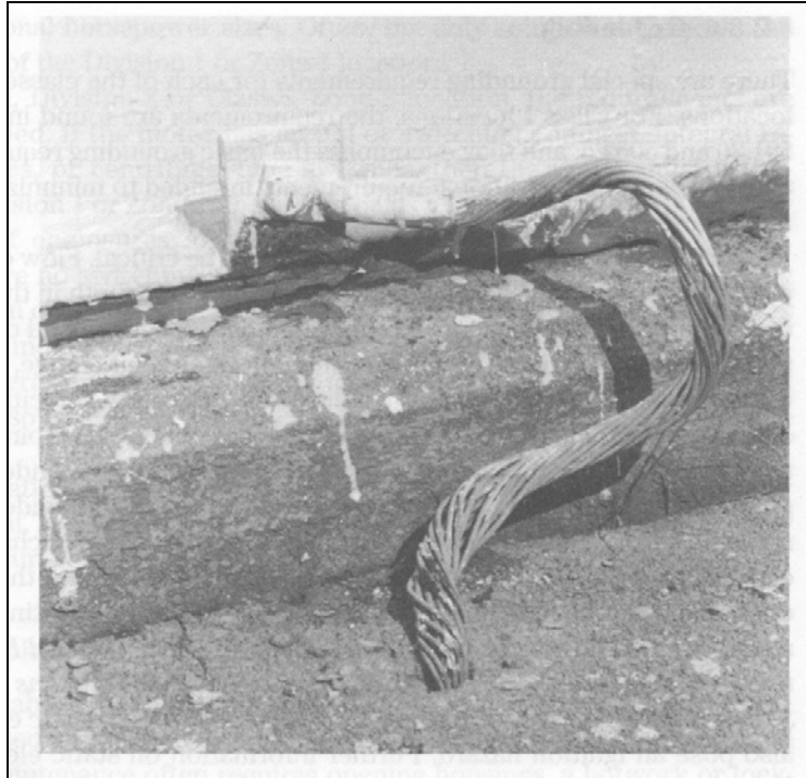
Figura 5.2 puesta a tierra en tanques almacenadores
