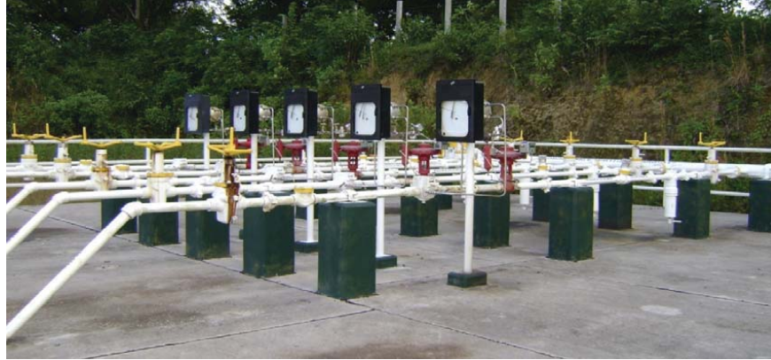
Figura 30. Manifold de inyección de gas
