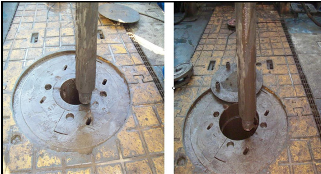
Figura 6. 6. Desalineación observada en el equipo de perforación.
