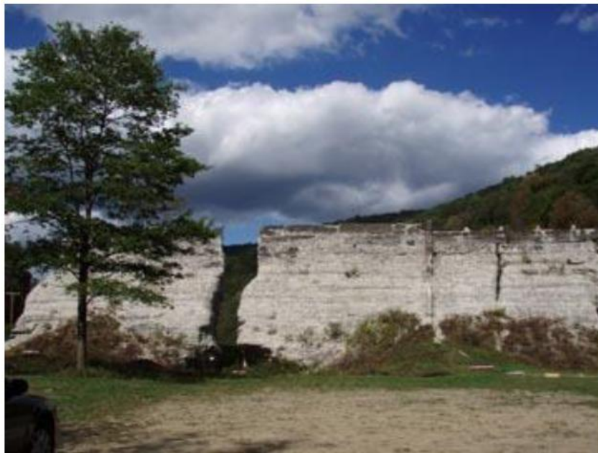
Figura 1.41 Falla en la presa Austin. (Marengo, 2011).
