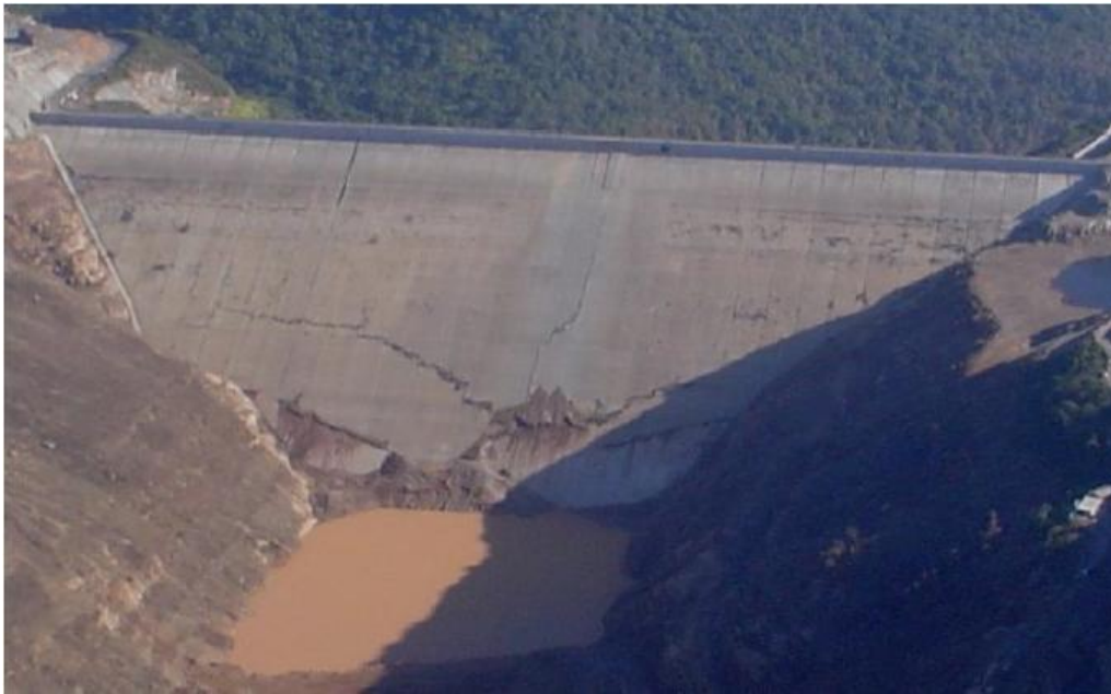
Figura 1.43 Falla de la presa Campos Novos se puede apreciar la fractura en la pantalla de concreto. (Marengo, 2011)
