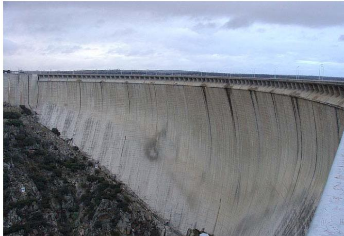
Figura 1.9 Presa de arco de doble curvatura. Se puede observar con claridad la forma de la bóveda; de aquí por qué recibe también este nombre. (Villarino, 2006)
