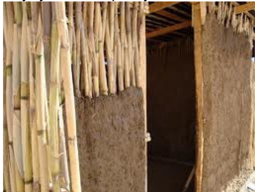
Figura 3.3 Vivienda con carrizo en muros
