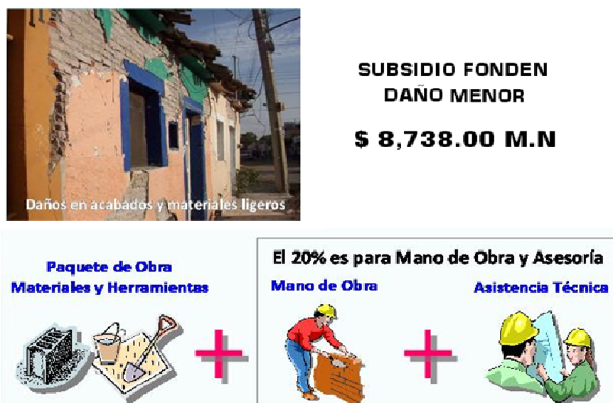
Figura 2.3 Daños menores según las reglas del FONDEN. (SEDESOL)
