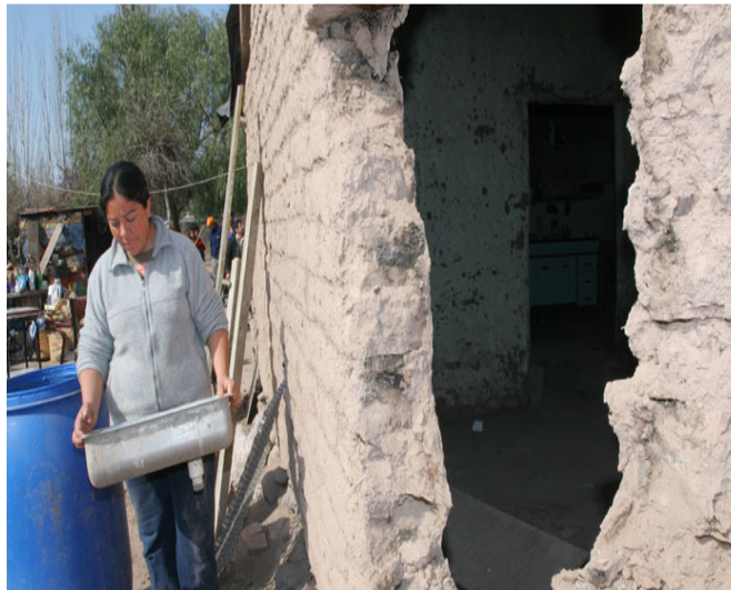
Figura B20. Ejemplo de muros parcialmente derrumbados o desplomados
