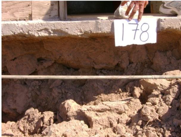
Figura B9. Ejemplo de una socavación parcial alrededor de la cimentación
