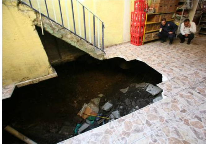
Figura B15. Ejemplo de hundimiento
