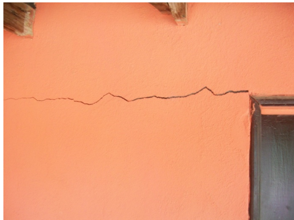
Figura B18. Ejemplo de grietas horizontales en muros
