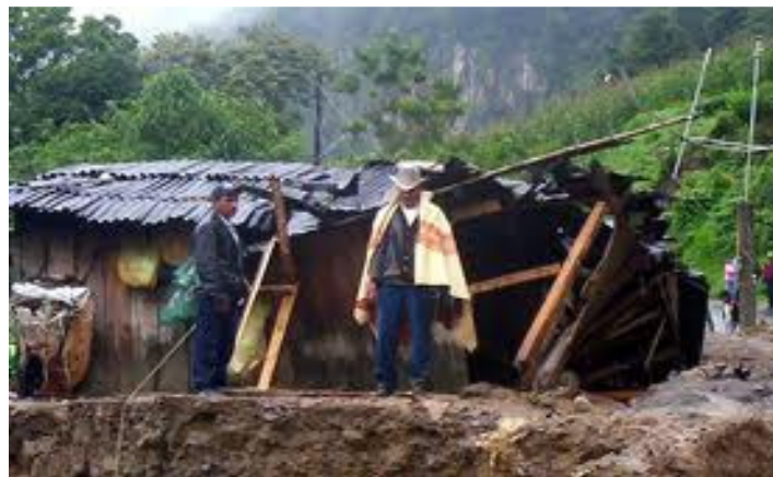
Figura B16. Ejemplo de daños en muros de materiales ligeros o flexibles
