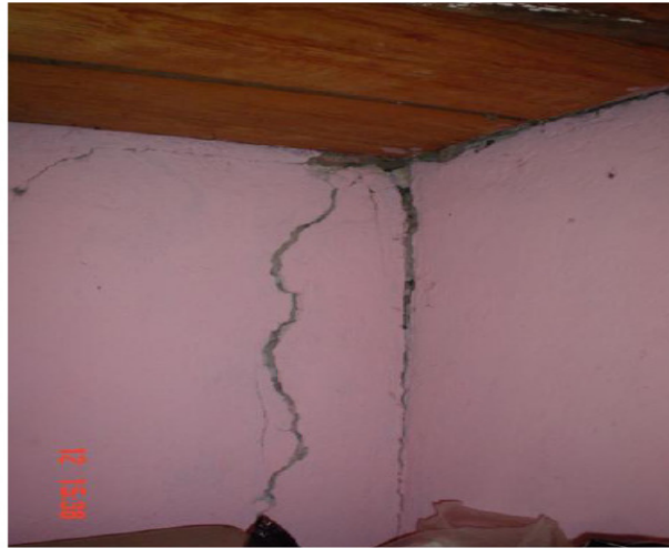
Figura B19. Ejemplo de grietas verticales en muros
