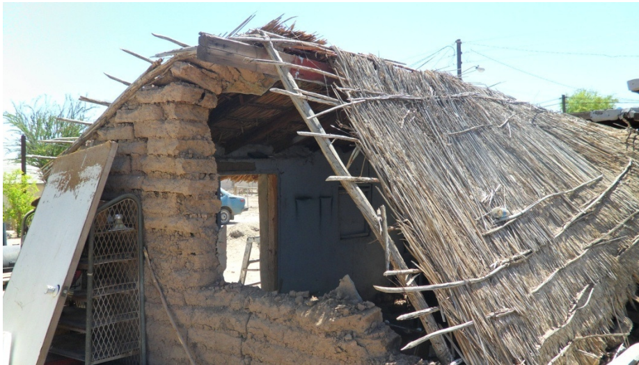
Figura B24. Ejemplo de desprendimiento de techumbres construida con materiales ligeros o flexibles
