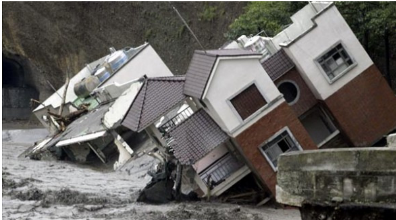
Figura B11. Ejemplo de socavación total y desplazamiento de la cimentación
