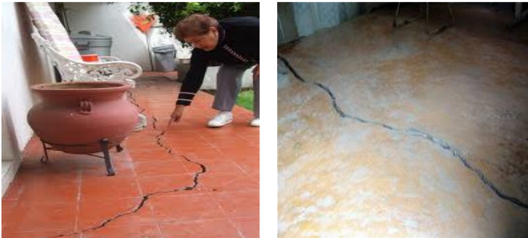
Figura B14. Ejemplo de grieta de pisos
