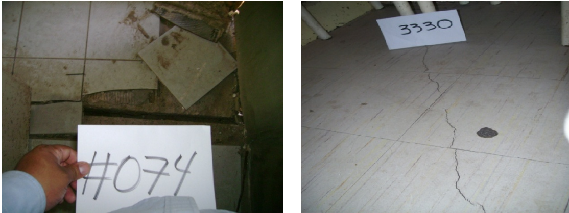
Figura B13. Ejemplo de desprendimiento de acabados y agrietamiento de pisos
