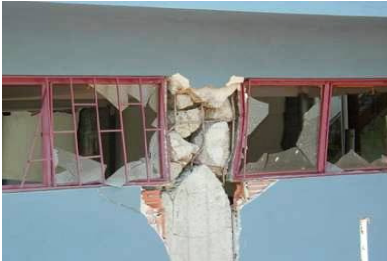
Figura B23. Ejemplo de Fractura de columnas
