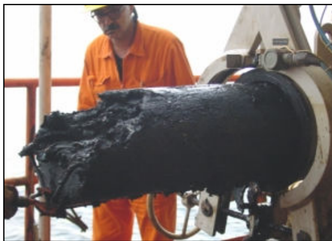
Figura 1.16. Obstrucción por Presencia de Parafinas y Asfaltenos.
