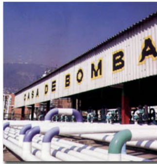
Figura 5.9 Instalaciones de la terminal Satélite norte en San Juan Ixhuatepec
