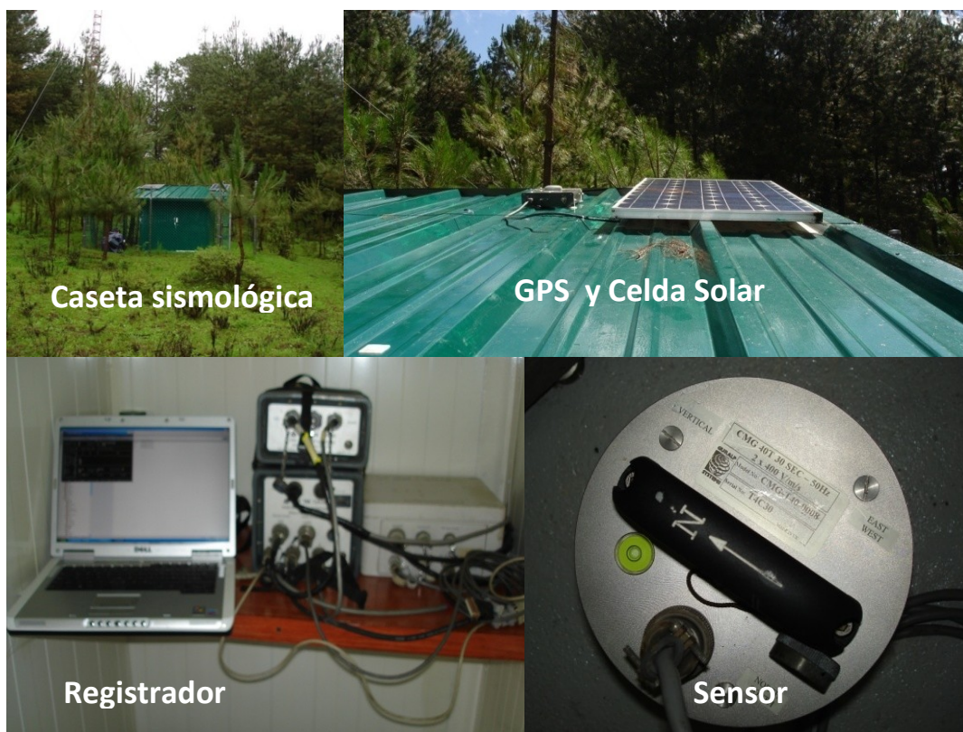
Figura 2.2.2. Parte superior vista panorámica de la caseta sismológica El Mono (MOAZ); la ubicación de la celda solar y el GPS. Parte inferior; sismómetro Guralp T40-0008, el registrador Reftek modelo 72-A08 de 24 bits y un disco duro de 2 GB para almacenar información sísmica continua.
