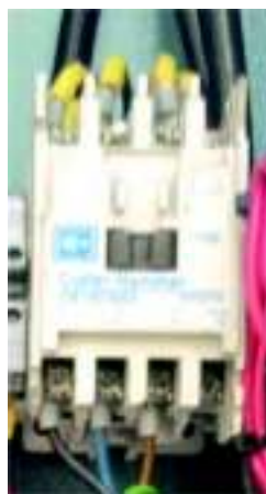
Fig. 2.6 Contactor Cuttler - Hammer suministrado por el cliente.
