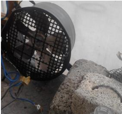
Fig.86.-Ventilación por medio de ventiladores.
