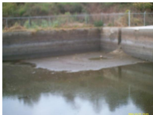
Fig.49.- Depósito para suministro de agua de riego.
