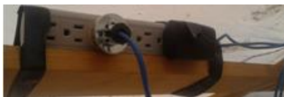
Fig.66.-Cableado y aditamentos.
