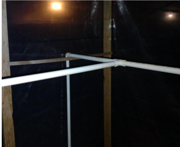
Fig.76.-Tubería de PVC para la aspersión.
