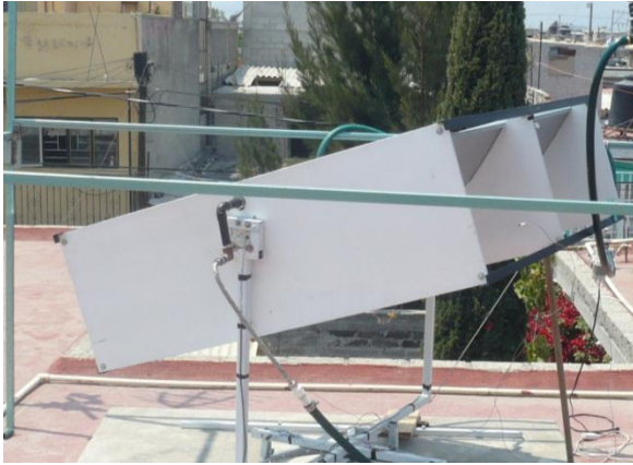
Figura 68: Colector en operación 1 p.m.
