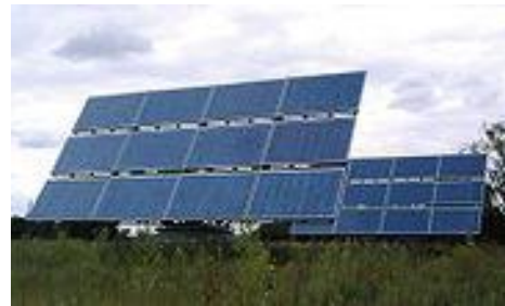
Figura 1: Seguidor solar fotovoltaico
