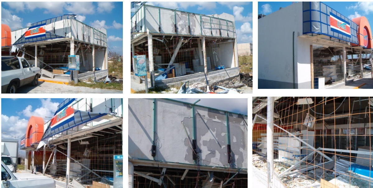
Figura 2.30 Daños en minisuper de la gasolinera 10G
