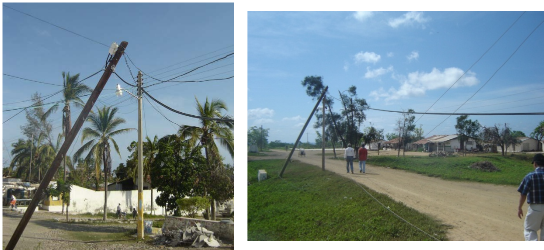
Figura 2.15 Líneas de energía y de teléfono afectadas
