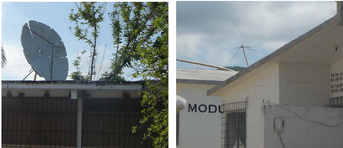
Figura 2.13 Antenas y paneles solares afectados
