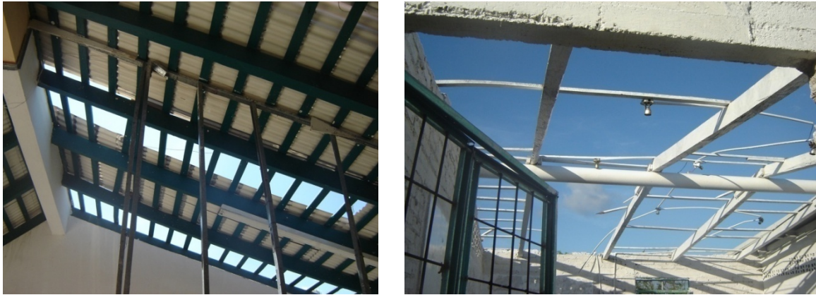
Figura 2.10 Desprendimiento de las cubiertas (parcial y total)
