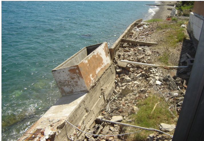
Figura 2.18 Muro rompeolas afectado por la socavación
