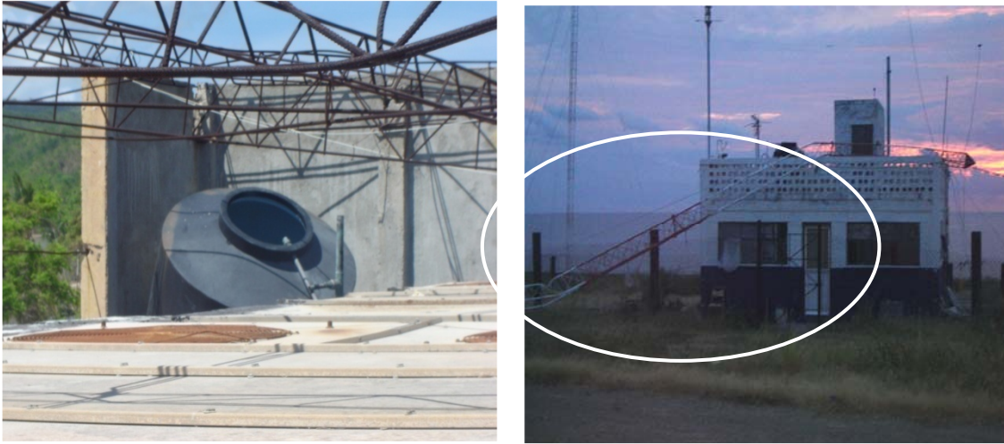
Figura 2.12 Tinacos y antenas desprendidos
