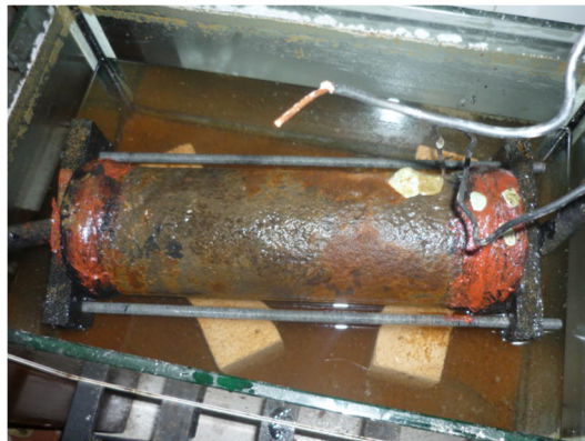
Figura 3.4, Fotografía del tubo desnudo a 10°C al finalizar el monitoreo.
