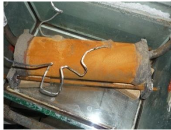
Foto 3.11 Corrosión a altas temperaturas
