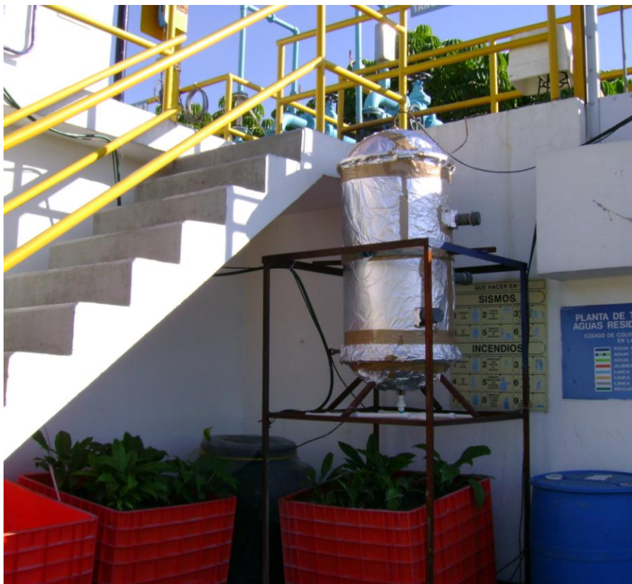
Figura 3.12. Montaje del biofiltro percolador anaerobio de flujo continuo y humedales
