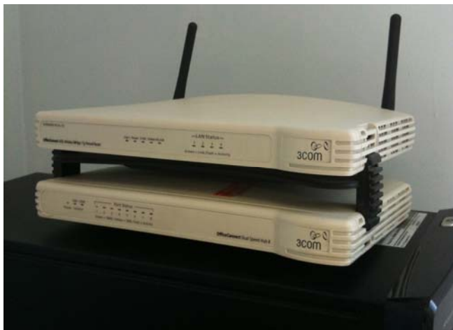
Fig. No. (10) Router con Firewall
