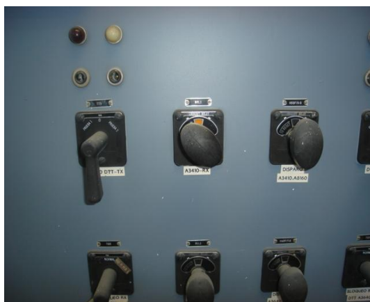
Figura 4.6.1. Operación de relevador auxiliar 86L3.
