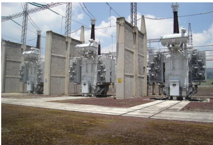
Figura 2.1.2. Banco de Autotransformadores 400/230 kV.
