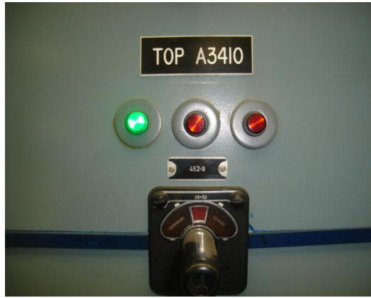
Figura 4.6.2. Apertura de interruptor A3410.
