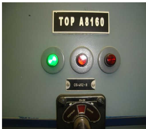
Figura 4.6.3. Apertura de interruptor A8160.
