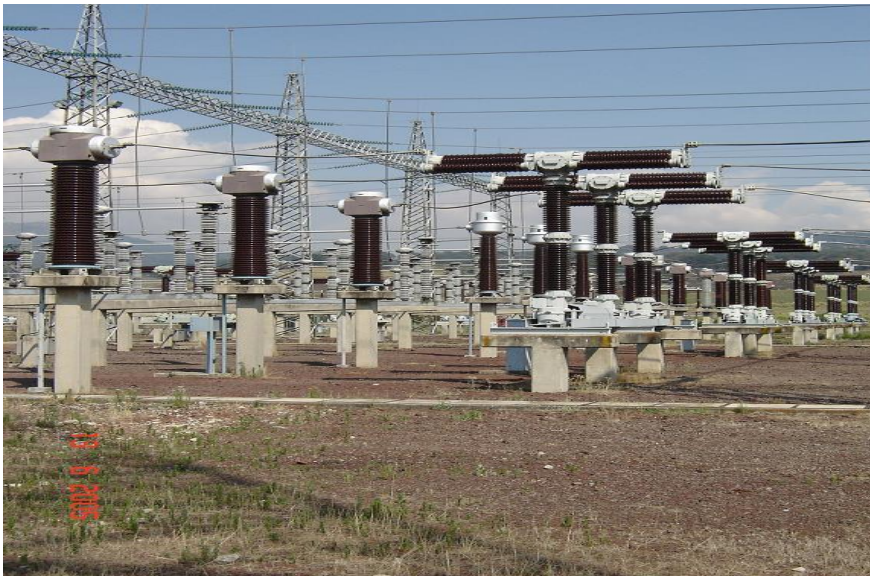
Figura 3.2.5 Equipo primario de una Línea de Transmisión.
