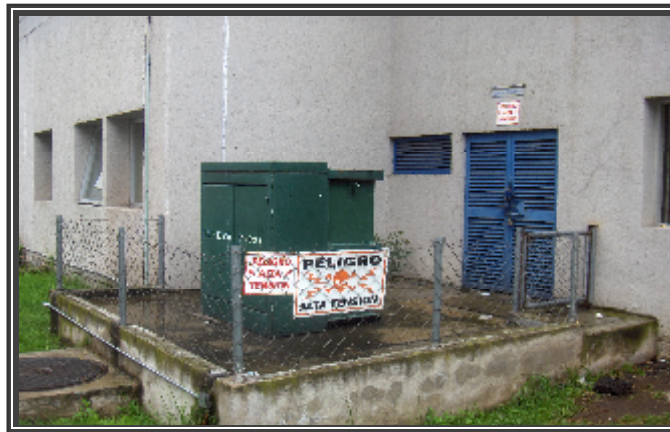
Figura No. 2.3. Transformador tipo pedestal.
