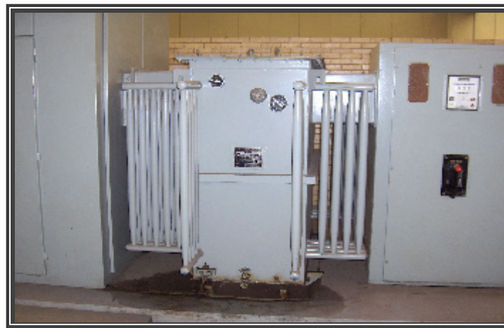
Figura No. 2.5. Transformador tipo subestación.
