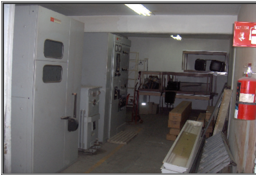
Figura F. Subestación Derivada.
