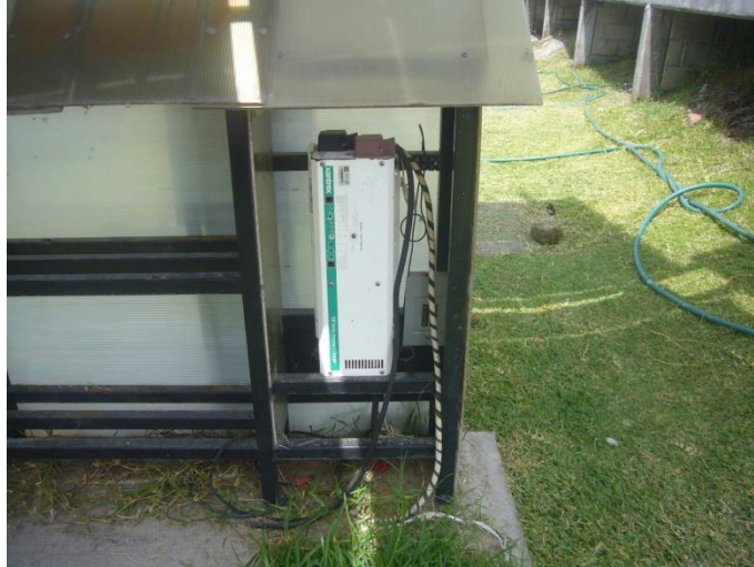
Figura 2.24 Caseta para el inversor.
