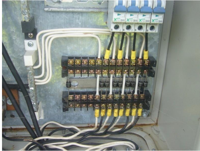
Figura 2.11 Diodos colocados en inversa en la caja de paralelismo.
