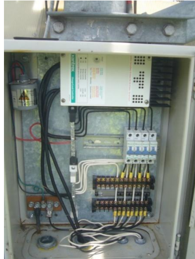
Figura 2.3 Caja de paralelaje se puede ver que tiene sus debidas protecciones y cuenta con su controlador para el banco de baterías.
