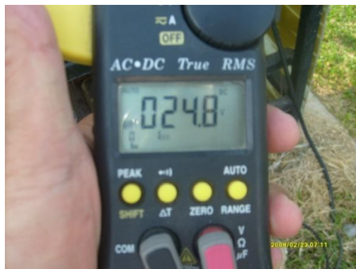
Figura 2.29 Medición tomada en el banco de baterías al realizar las pruebas.
