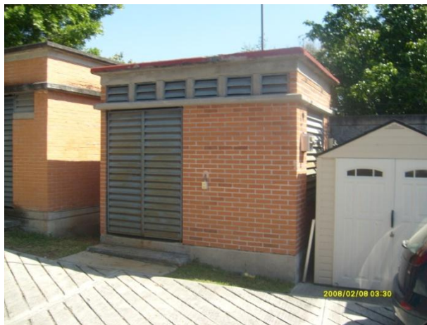
Figura 2.25 Caseta vista por fuera a la que se le entregará corriente por medio de un arreglo fotovoltaico.
