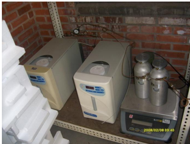
Figura 2.26 Generadores de hidrogeno que se encuentran dentro de la caseta y serán las cargas de nuestro sistema.
