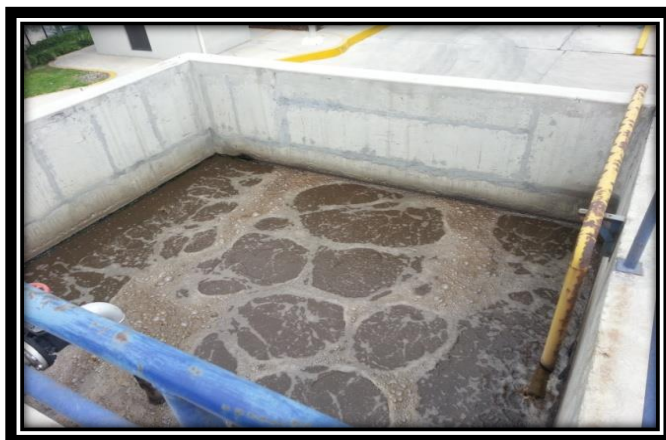
Figura 3.10 Reactor biológico con aireación, se observa la recirculación de los lodos a través de la tubería amarilla.
