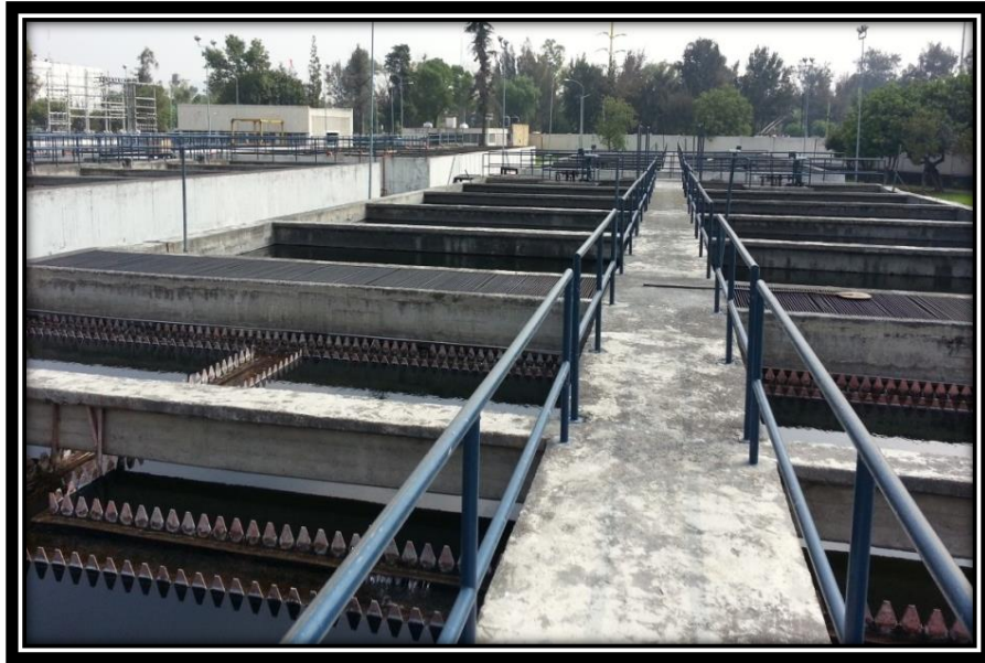
Figura 3.21 Vista general de uno de los tanques de sedimentación secundaria con sus respectivos clarificadores.
