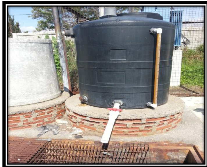
Figura 3.40 Sistema de desinfección del efluente por goteo de hipoclorito.
