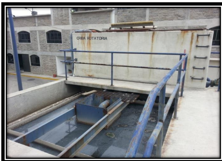
Figura 3.9 Criba rotatoria y unidad de sedimentación primaria, ambas fuera de operación al momento de la visita.
