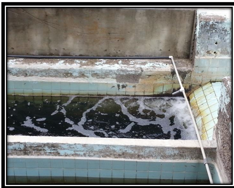
Figura 3.33 Instalación para la desinfección del efluente del tratamiento secundario con hipoclorito por goteo.
