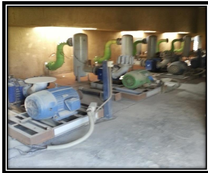
Figura 3.38 Equipos sopladores para la aireación de los reactores biológicos. Se encuentran en estado pobre de mantenimiento.
