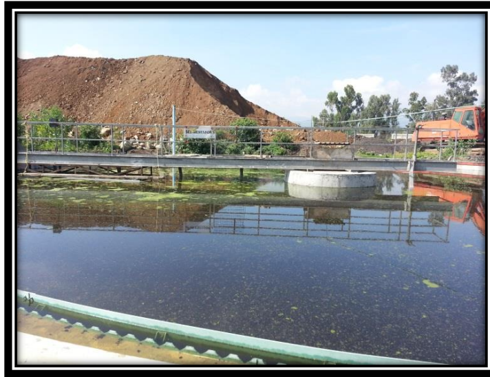
Figura 3.39 Vista general de uno de los tanques de sedimentación secundaria. Presenta un estado de pésimo mantenimiento pero funciona adecuadamente.
