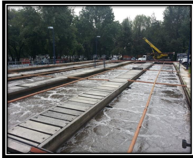
Figura 3.29 Vista general de reactor biológico rectangular en tren de tratamiento I.
