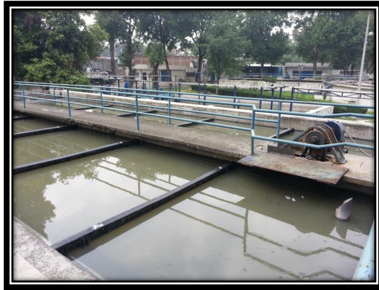
Figura 3.27 Tanque de sedimentación primaria rectangular en tren de tratamiento I.
