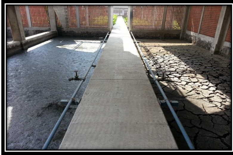
Figura 3.49 Interior de uno de los lechos de secado de lodos, del lado izquierdo se observa un lodo fresco, mientras que a la derecha se tiene un lodo a punto de finalizar su secado.
