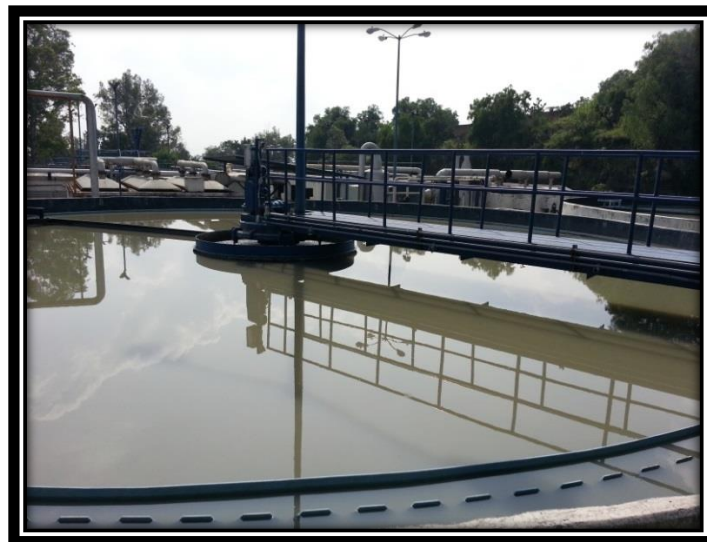
Figura 3.45 Vista general de uno de los sedimentadores circulares con que cuenta la planta de tratamiento.
