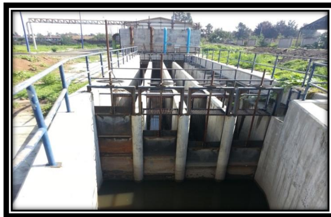
Figura 3.36 Compuertas reguladoras de gasto y rejillas de limpieza mecánica a la entrada del agua residual a la planta.
