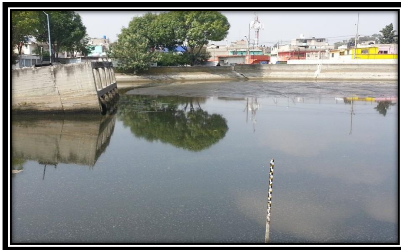
Figura 3.23 Vista general del tanque de almacenamiento de agua tratada. Se aprecian con claridad los daños que ha causado el hundimiento diferencial del terreno de la planta en la estructura del tanque.
