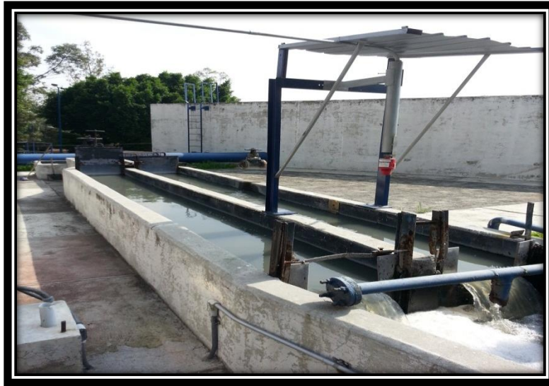
Figura 3.44 Canales desarenadores con su respectivo aparato de medición digital de gasto
