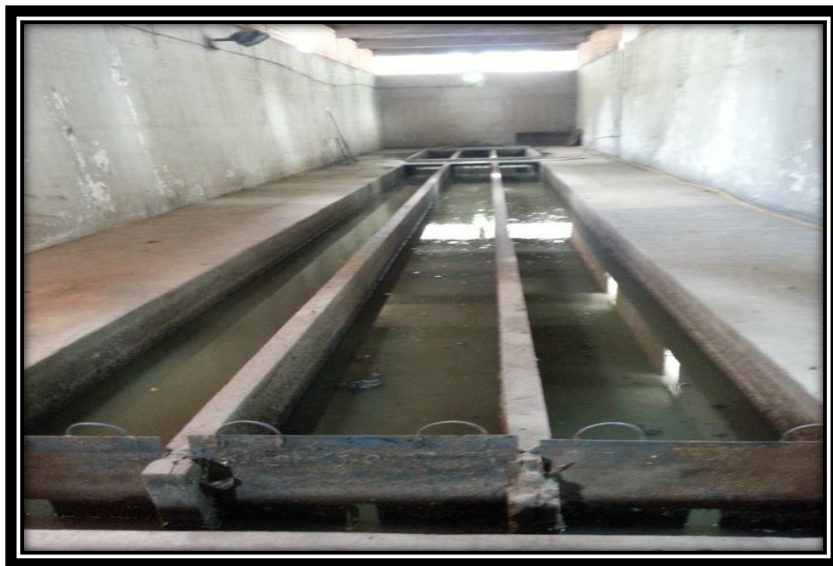
Figura 3.25 Tratamiento primario que consiste en rejillas de limpieza manual y canales desarenadores.
