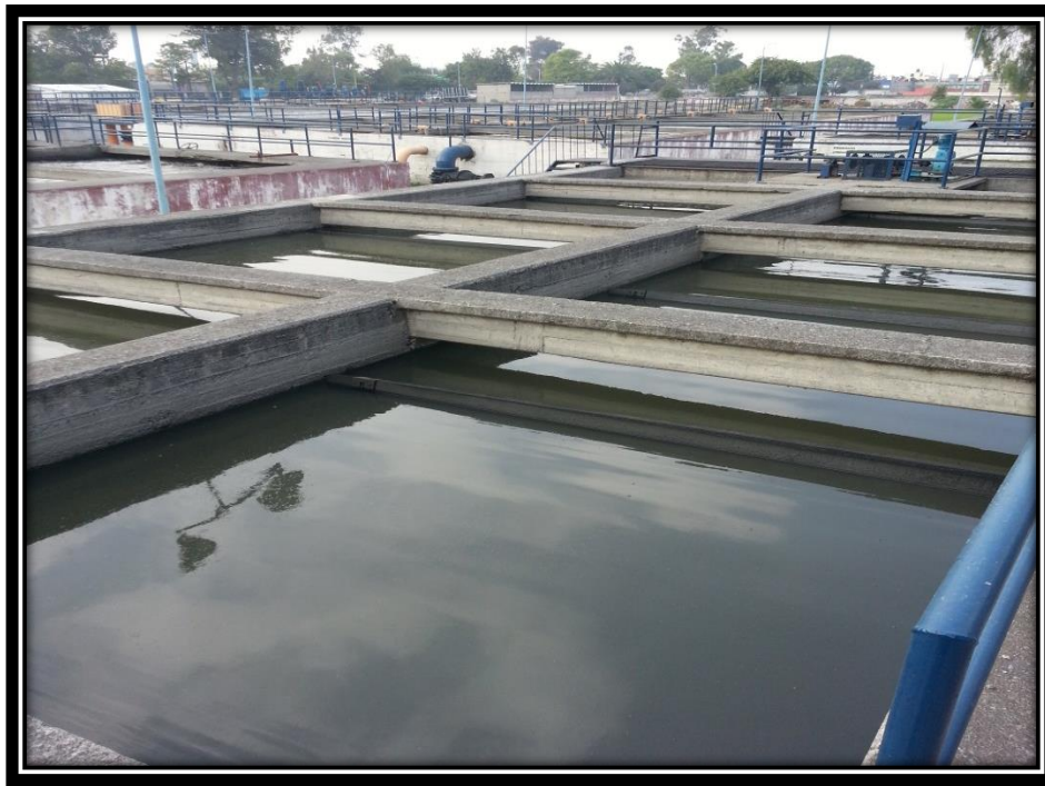
Figura 3.18 Vista general de uno de los sedimentadores primarios, del lado opuesto presenta algunas dragas fuera de servicio por falla mecánica.
