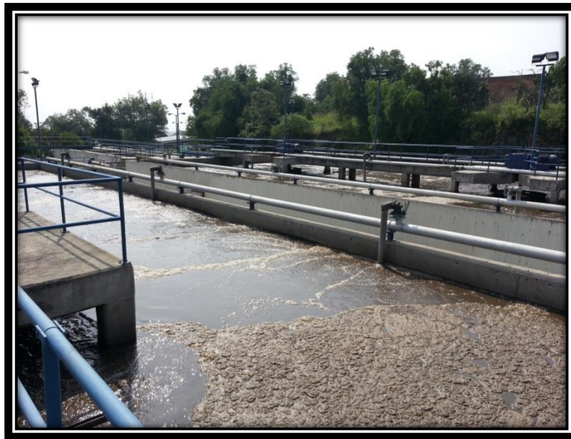
Figura 3.46 Vista general de uno de los reactores biológicos rectangulares de la planta. Se observa acumulación de lodos en la superficie debido a fallas eléctricas en los aireadores.
