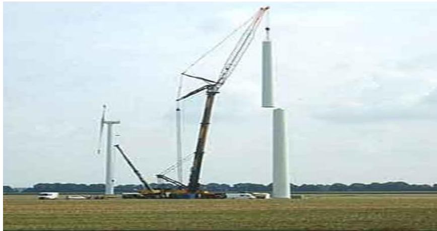
Ilustración 54. Momento de izado de las partes de la torre de un aerogenerador
