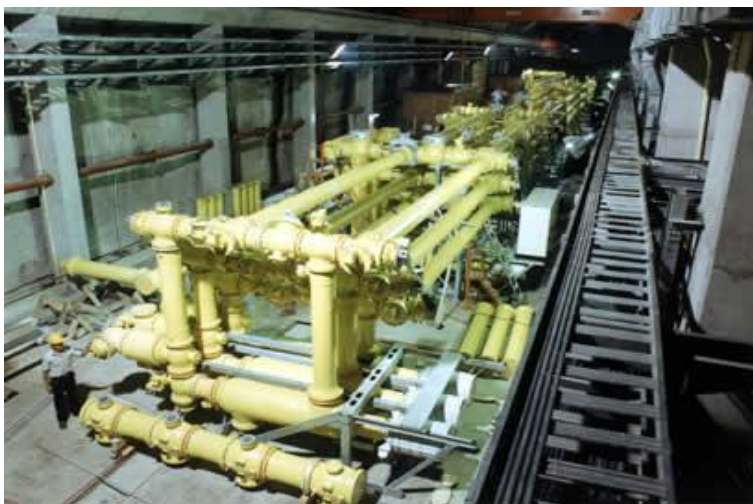
Ilustración 56. Subestación en SF6
