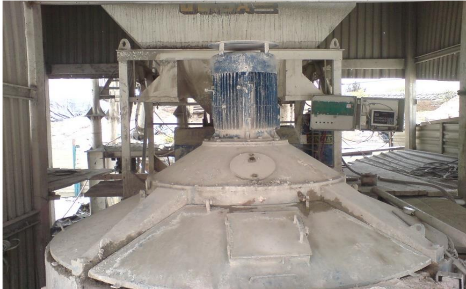
Figura (69) Tanque de mezcla de lodos
