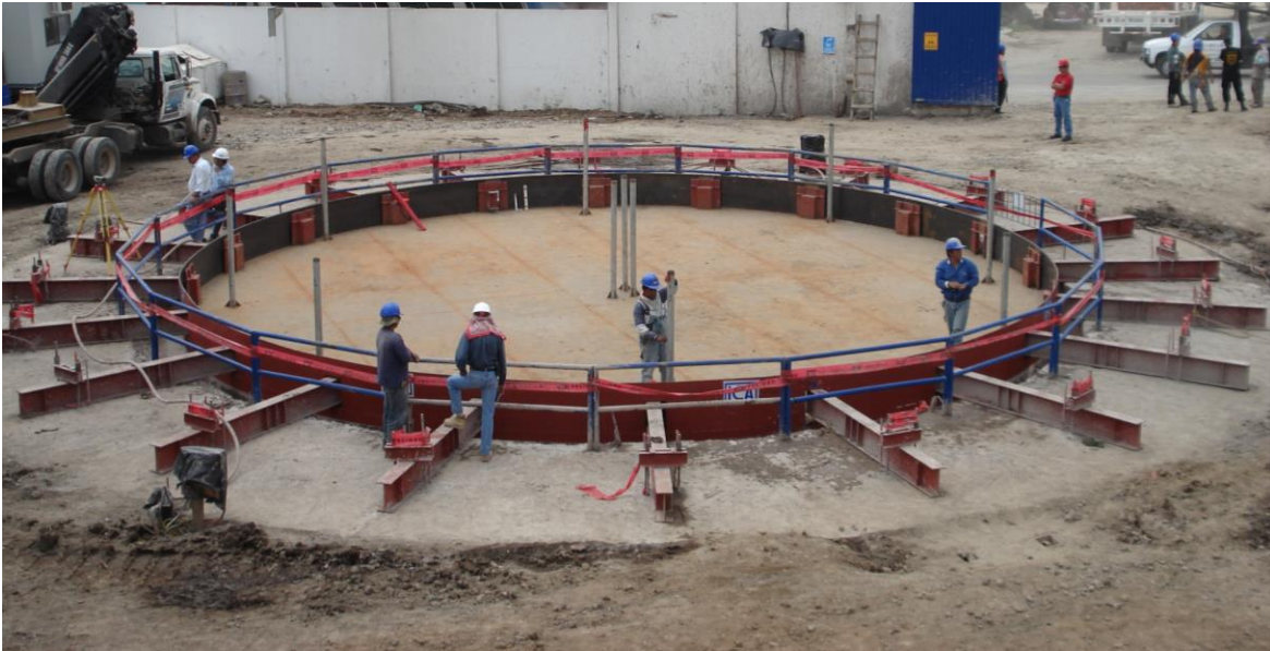
Figura (57) sujeción del tanque de flotación
