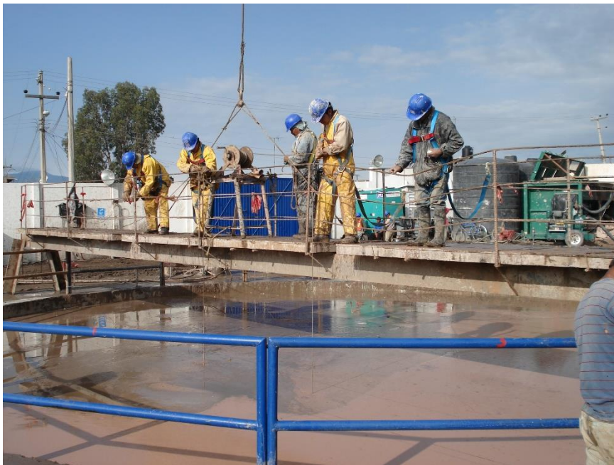
Figura (53) revisión de profundidad
