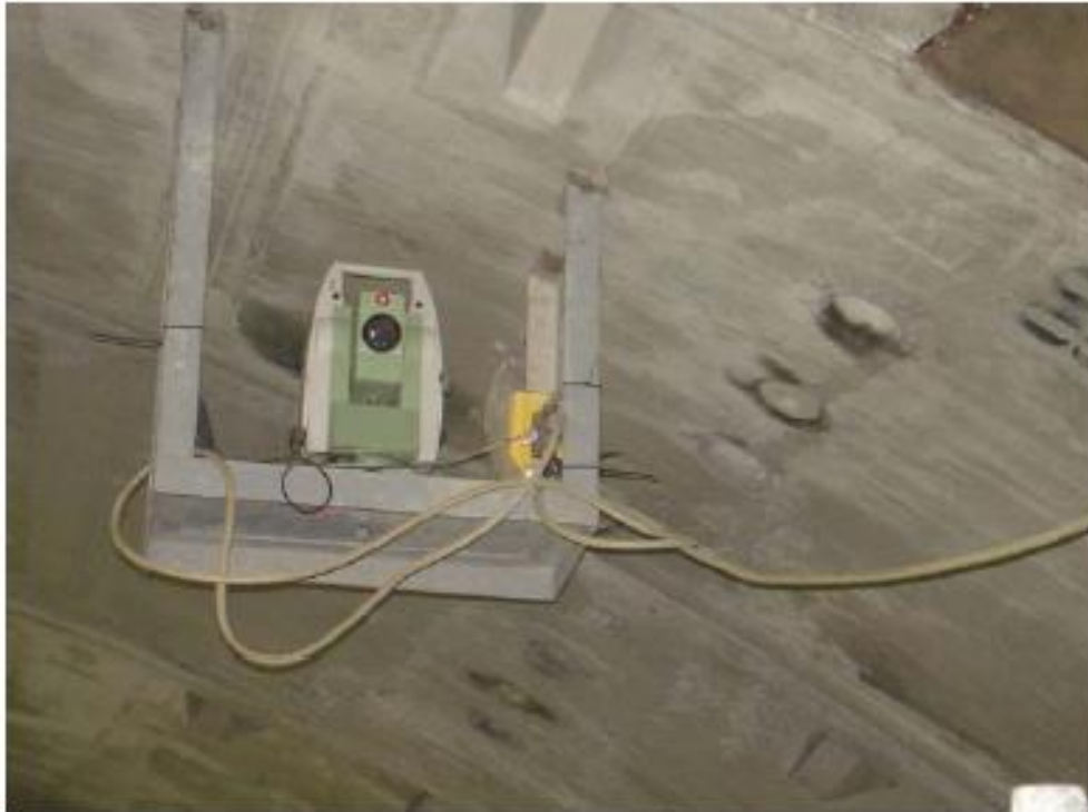
Figura (32) Teodolito Sistema de Guiado en el Túnel
